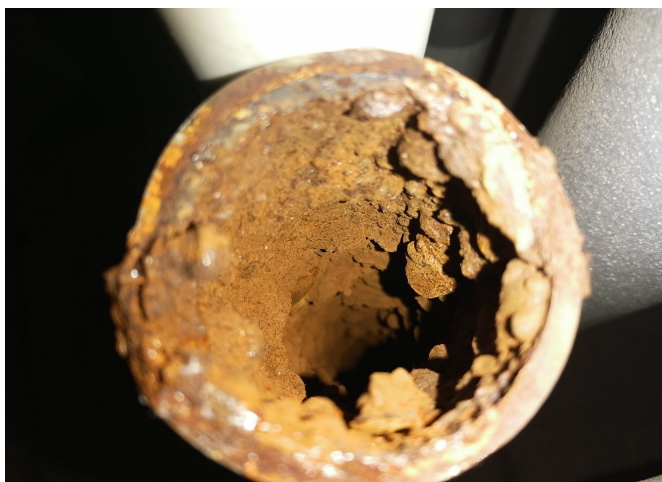
Коррозионные отложения оцинкованного стального трубопровода
