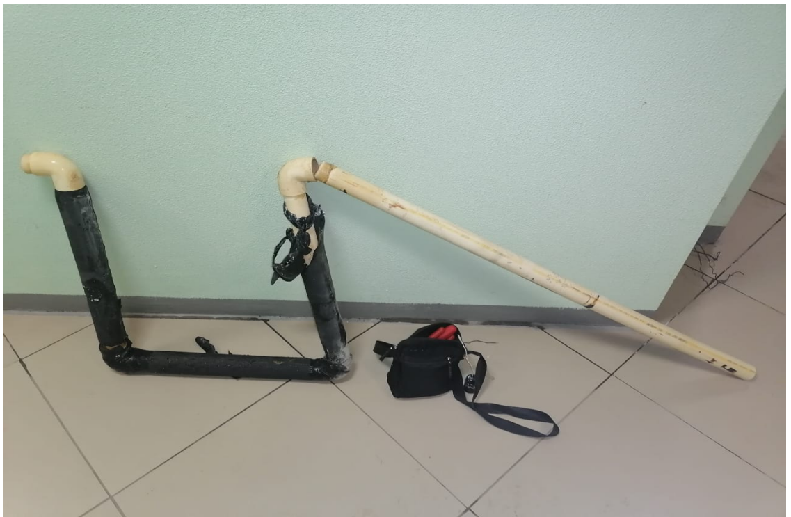
Пример разрушения ХПВХ трубопровода
